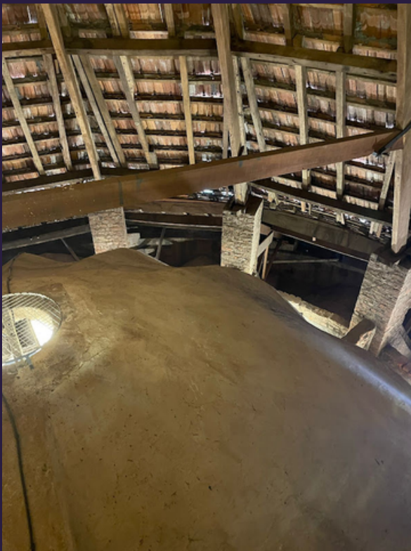
Detalhe da estrutura do telhado sobre o deambulatório com destaque para uma das abóbadas de teto do templo. Fonte: Lopes; Campbell; Araujo; Lott, 2023.
